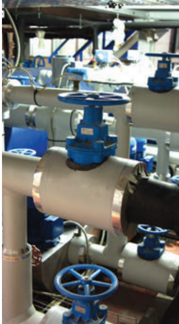
Il complesso sistema di pompe, tubi e valvole che consente di raffreddare le singole zone della linea d'estrusione
