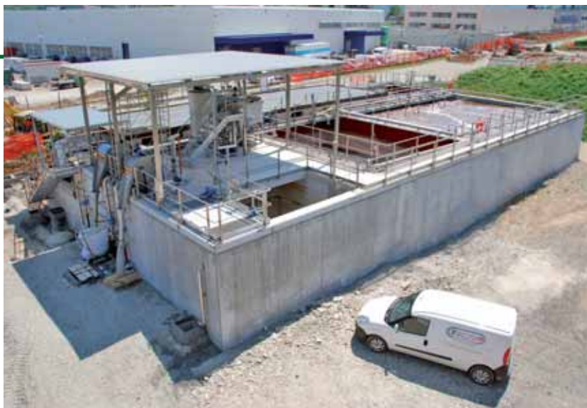
Equipamento de tratamento integral da água da seção de filtração mecânica, etapa química/física e seção biológica para abatimento de material orgânico dissolvido
