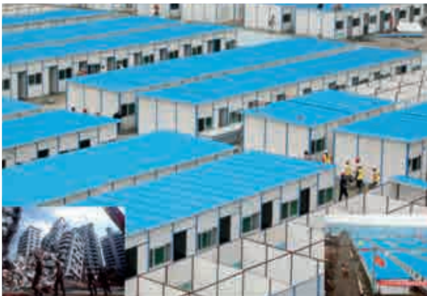
Fig. 2 - Nel 2008, in Sichuan (Cina), più di 1 milione di prefabbricati green è stato connesso con tubi per acqua, gas ed elettricità in sole 6 settimane
