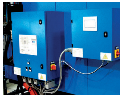
Il sistema di controllo Magnets Master Controller (M2C) con l'aggiunta, a destra, del nuovissimo Force Evaluation System
