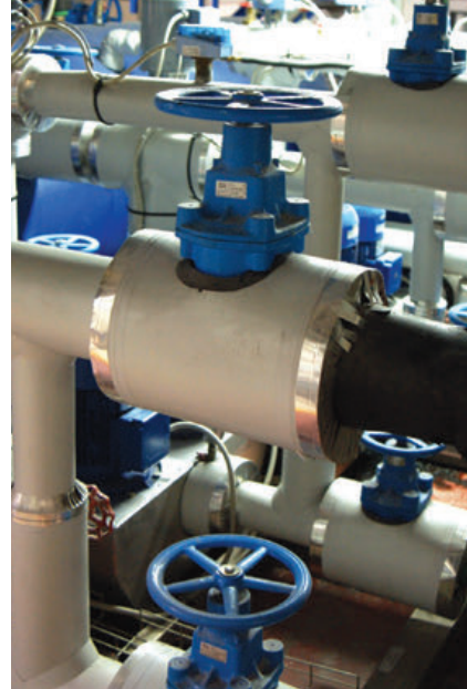
El complejo sistema de bombas, tubos y válvulas que hace posible el enfriamiento de todas las zonas de la línea de extrusión
