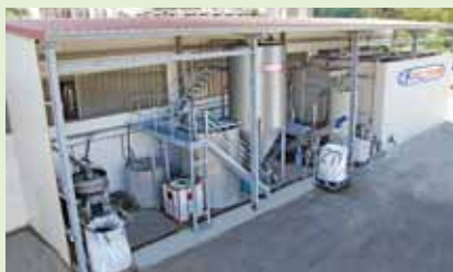
污水处理/循环利用系统, 具有20立方米/小时的能力, 配备了生物部分和辅助2000千克/小时的联塑烯(HDPE)瓶回收生产线
